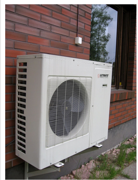
Exterior de un sistema de aire acondicionado moderno (Unidad dividida o tipo "split").
